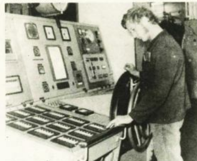
Heinz Kühne, II. Ingenieur, am Fahrpult. Hier erfolgt die Störwertüberwachung zentral an einem Pult und erleichtert so die Arbeit. Da das Schiff mit Aut-16-Betrieb fährt, ist die Anlage mit der Brücke und den Kammern des Maschinenpersonals gekoppelt. Gigantische Ausmaße im Maschinenraum mit einer Leistung von 13 700 PS beeindrucken und lassen die Leistungen der 14 Genossen in diesem Bereich ahnen. Nach dem Einarbeiten der Genossen wird ihre Anzahl reduziert, um der Automatik des Schiffes gerecht zu werden.
